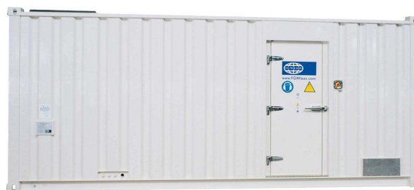
Agregat w kontenerze
